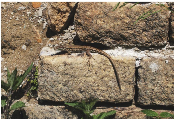
58 Mauereidechse im Handquadermauerwerk des nördlichen Torturms des Osttores (PE_M11).
