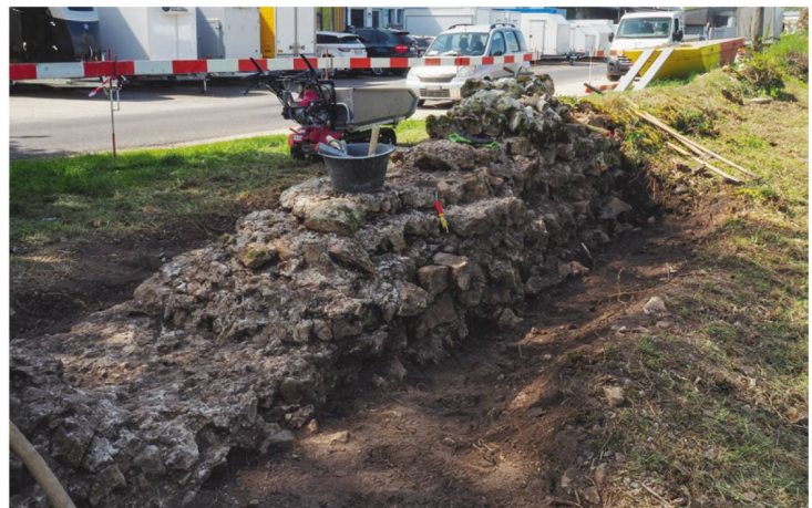
61 Freigelegter und gereinigter Mauerkerne auf dem Abschnitt T8–T9. Anschließend wurde das originale Mauerwerk mit einer Trockenmauer aus Kalkbruchsteinen überdeckt (2019).
