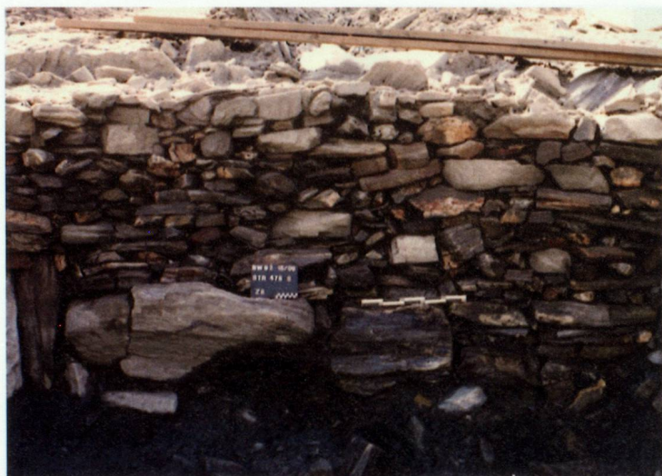
Fig. 136 – Bâtiment Bat13. Détail de l'appareillage du mur sud. Les modules de pierre sont plus gros à la base du mur et plus petits en élévation. Vue depuis le nord.
