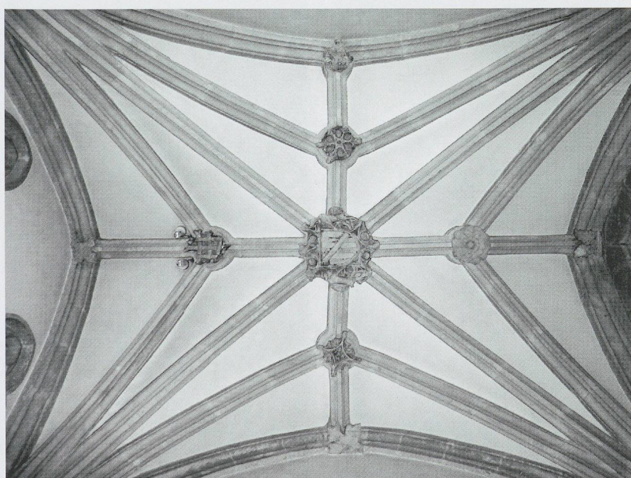
Fig. 234. Le château de Planaz (Desingy). La voûte de l'ancienne «chapelle neuve» de noble Pierre de Viry (vers 1520), actuellement remontée à la chartreuse du Reposoir en Faucigny (photo Livio Fornara, 2014).
