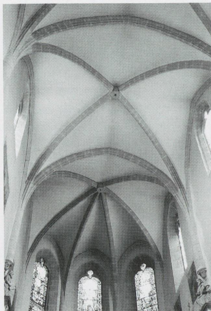
Fig. 182. L'ancienne église des Cordeliers d'Annecy. Le chevet, exceptionnellement tourné vers le nord, avec ses fenêtres allongées et murées dans leur partie basse (photo MG, 2010).
