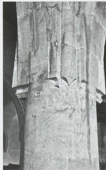
Fig. 20. L'église paroissiale de Môtiers-Travers. Raccord entre la première pile cylindrique au nord-est de la nef et la retombée des arcades et de la croisée d'ogives du collatéral (photo MG, 2009).
