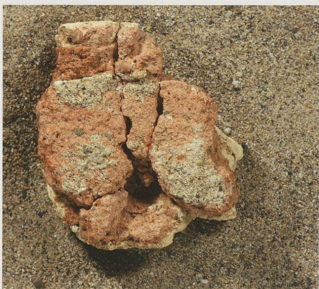
Fig. 267. Vestige du mortier de sable de la structure portante, au revers de la corniche Cateps 4, fgt 1 (04/13419-1a). Éch. 1/2.
