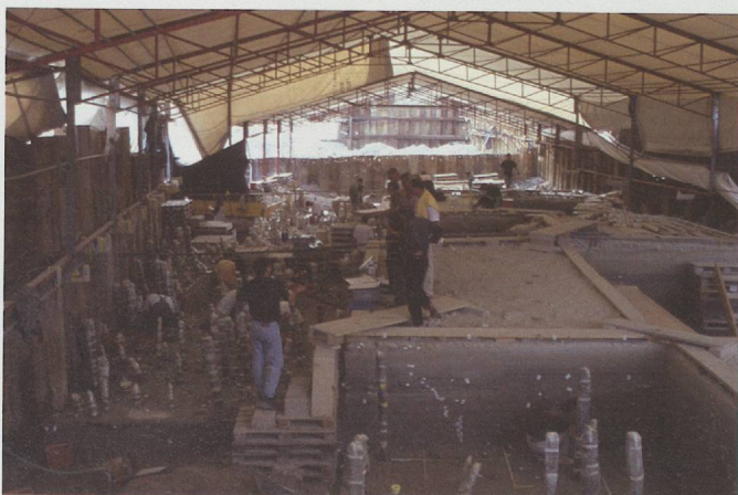
Pl. 4c. Caisson principal de la zone 3 en septembre 1999, vue prise depuis le canal de la station d'épuration en direction d'Yverdon. Le secteur 196 au centre est maintenu pour permettre la circulation et l'évacuation des sédiments.
