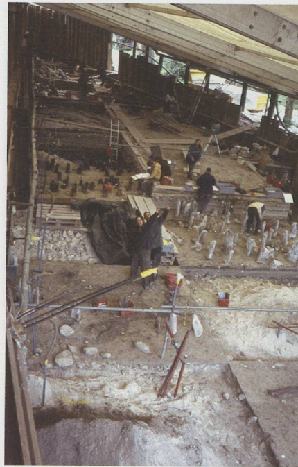
Pl. 4d. Zone 2 en septembre 1997, vue en direction de l'est. Au fond, les deux portes découpées dans le rideau sud du caisson de palplanches.
