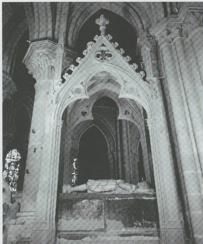
Fig. 148. Vue générale, face nord (tournée vers le déambulatoire). La disparition partielle de la couche de peinture noire, destinée à imiter le marbre de Saint-Triphon, laisse apparaître la molasse utilisée à l'arrière du tombeau.
