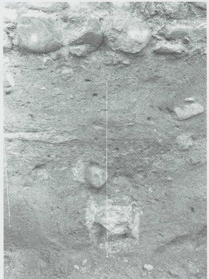
Fig. 34. Maison A, local 3 (état 4a). Vue en coupe du mur 170, dont la fondation est constituée de pierres liées au mortier.
