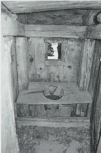
862.2. Château de Vuissens, habitacle charpenté des latrines accroché contre la courtine orientale. Etat en 2003. (D. de Raemy)
