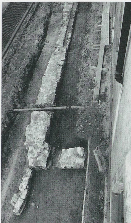
716. Yverdon, rue du Casino, fondations des façades occidentale et méridionale des anciennes écuries de LL.EE. dépendantes du château, réédifiées en 1698 sous la direction du secrétaire baillival Marc de Treytorrens. Etat en 1989. (Fibbi-Aeppli)
