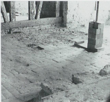
702. Château d'Yverdon, aile sud, grand vestibule sombre [120-1 à 4], vue du sol en terres cuites retrouvé sous les planchers lors des travaux de 1963. On observe, contre le mur en pan-de-bois de 1685 et contre la courtine sud, une zone dépourvue de carreaux, lesquels ont été enlevés et remplacés sans doute par un plancher en 1761 pour une chambre des domestiques. Au premier plan, on voit l'extrémité d'une épaisse dalle en béton (armé?) posée en 1943 sur la voûte pour protéger le poste de commandement installé dans la cave, à l'angle sud de l'aile occidentale; cette dalle a été enlevée en 1965. (P. Margot)
