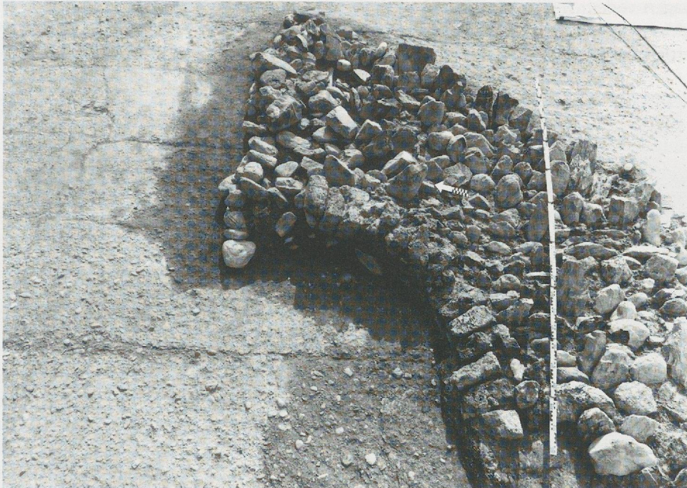
Abb. 8 Detail der eingestürzten Saalwestmauer mit der aus Tuffsteinen gefügten Fensterlaibung (5.1985)
