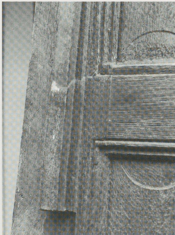
Fig. 80. Pilier en applique faisant office de couvre-joint contre l'encadrement en pierre de taille. On distingue un ressaut, trace probable d'une bague intermédiaire comme celles qui se trouvent sur les piliers des portes de l'Hôtel-Dieu à Beaune (voir fig. 84).
