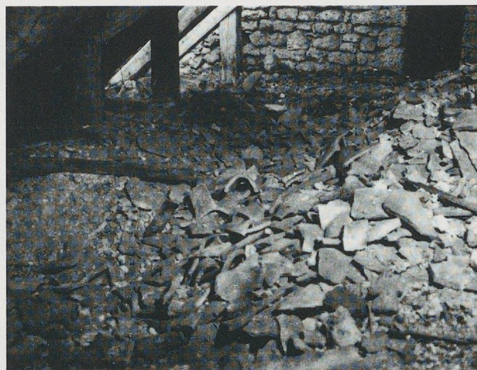
Fig. 2. Chésereux, église Notre-Dame de Bonmont. Vue des déblais de tuiles recouvrant l'extrados des voûtes du collatéral sud de l'église au printemps 1984.
