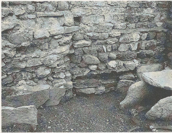
Fig. 49. Césure dans le fondement du mur nord de la cinquième église; vue vers le sud-ouest.
