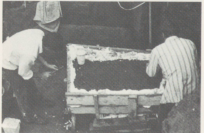
Fig. 11 Corseaux «en-Seyton». Coulage de la mousse de polyuréthane expansée; des interstices ont été aménagés pour faciliter le durcissement et laisser s'écouler le surplus.
