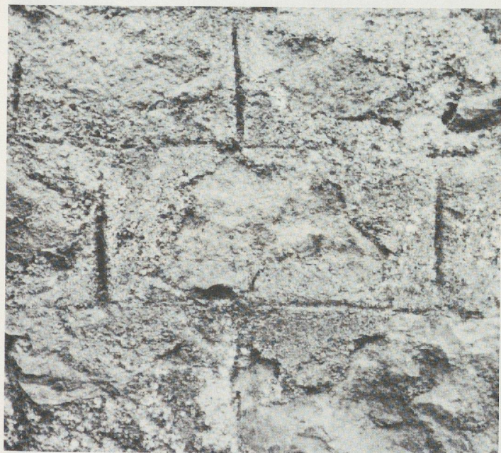
Fig. 127 Bât. est : vue rapprochée du parement nord du mur M6 : joints marqués au fer.
