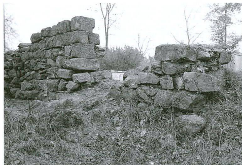
Fig. / Abb. 11 Mur de clôture oriental du château sud avec, au centre, le piédroit de porte encore conservé (état avant consolidation) Östliche Einfassungsmauer der südlichen Burganlage, in der Mitte der noch erhaltene Türpfeiler (vor der Konsolidierung)
