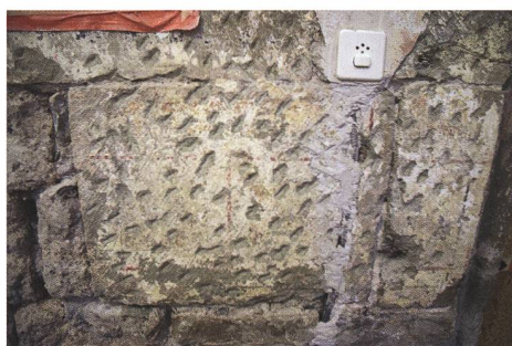
Fig. 14 Traces de décor en faux appareil sur la paroi ouest de la salle capitulaire (n° 3)
