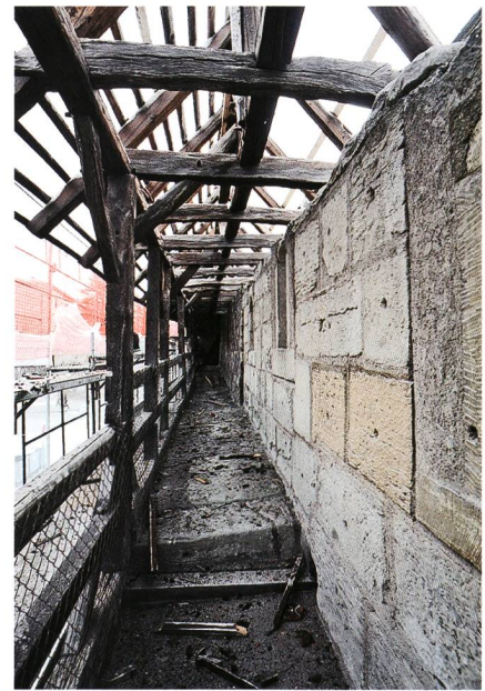
Fig. 9 Fribourg/Enceinte secteur tour du Blé. Chemin de ronde érigé en 1410-1412 et sa charpente de 1444/1445
