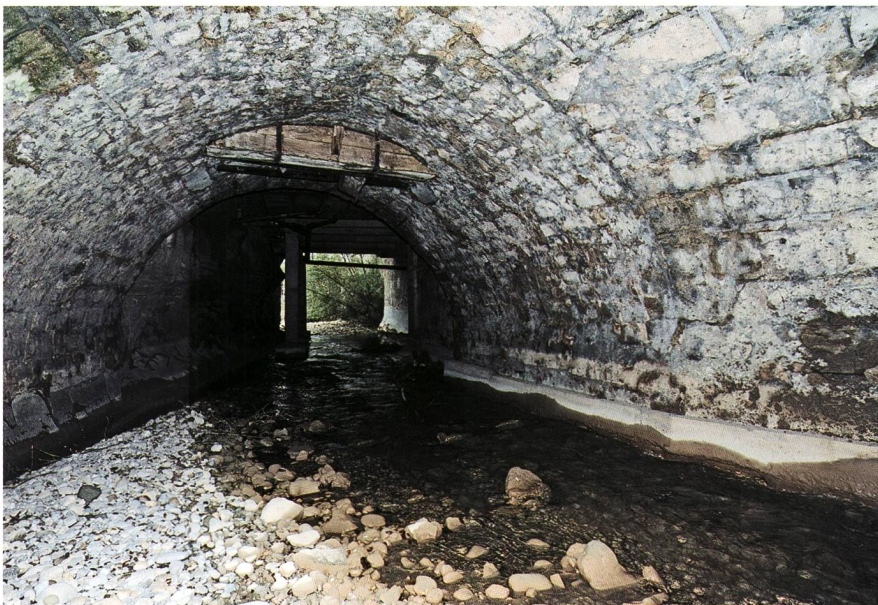
Fig. 13 Fribourg/Rue des Forgerons. Voûtes supportant la fontaine de la Fidélité et la chaussée sur le Gottéron
