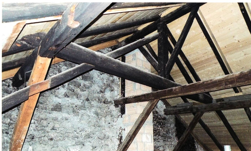
Abb. 6 Der Dachstuhl mit Blattsasse im Steigband und nachträgliche Abstützungen (alle modernen Bauteile sind aus hellerem Holz), Blick gegen die Brandmauer West
