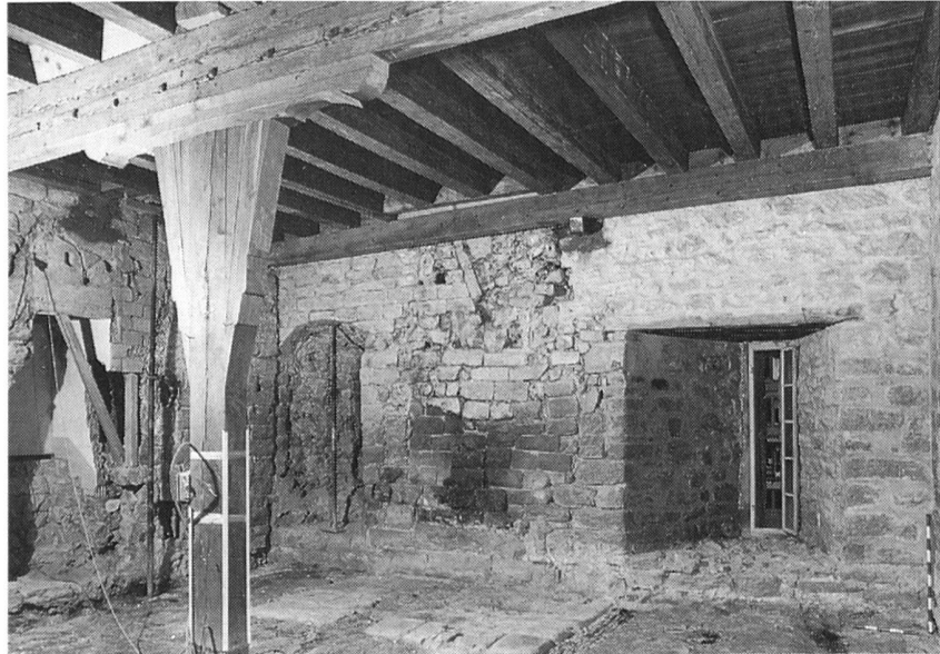
Fig. 132 Romont/Château. Vue de la salle 001; les vestiges des deux cheminées successives et de l'armoire occidentale sont bien visibles. L'archère de droite date de 1437 environ, l'autre de la 2 e moitié du XV e siècle. Le pilier de bois est une restitution moderne
