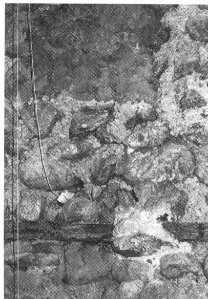
Fig. 66 Fribourg/Epouses 16. Les traces de lierre sur le parement occidental du mur de refend (troisième phase)
