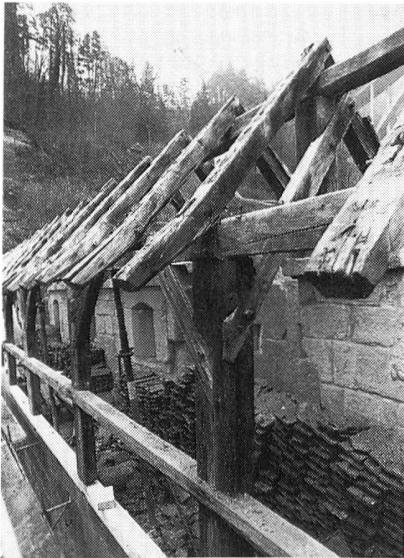
Fig. 92 Fribourg/Gottéron. La charpente de 1441/42 côté ville, état durant les travaux en décembre 1994
