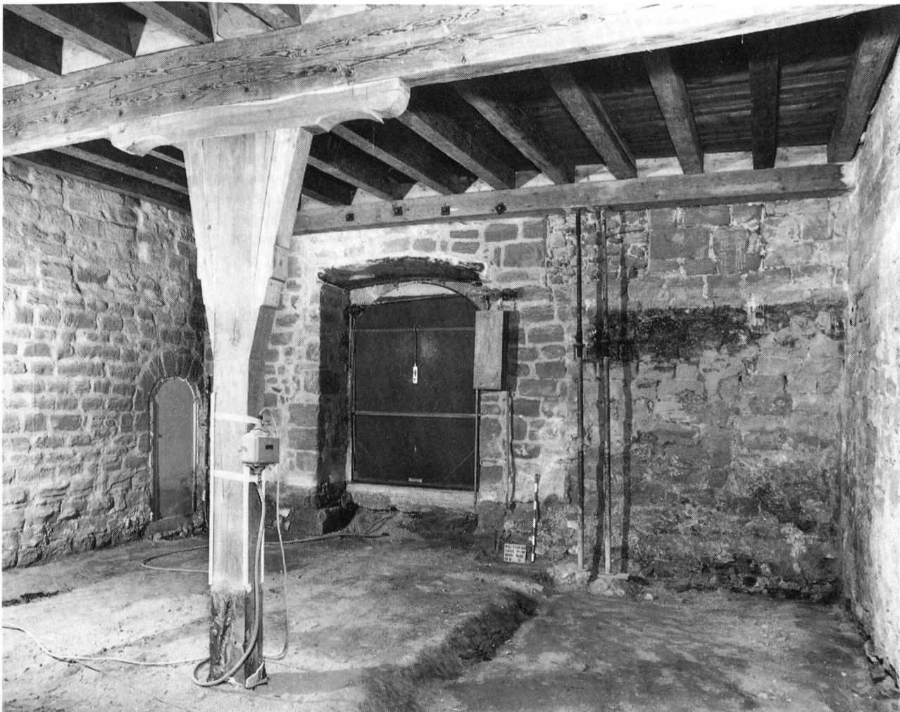
Fig. 135 Romont/Château. Extrémité sud de la salle 001. Les traces des deux petites fenêtres hautes du XIII e siècle sont visibles de part et d'autre de la porte de 1542 environ
