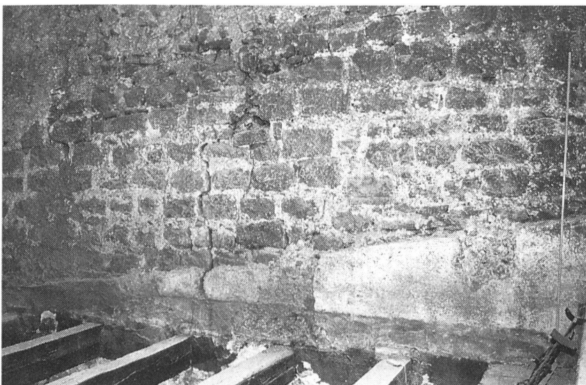
Fig. 72 Fribourg/Epouses 16. Le mur mitoyen nord et les traces du toit (cinquième phase)
