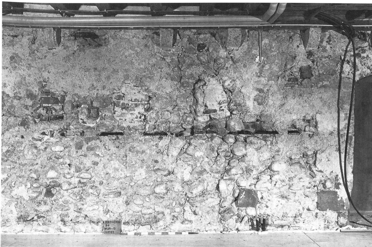
Fig. 21 Estavayer-le-Lac/Château de Chenaux. «Salle des archives», mur ouest. A remarquer: les plateaux de chêne répartis sur deux lignes horizontales, l'une à mi-hauteur, l'autre située au niveau des corbeaux soutenant le plafond du XVIII e siècle
