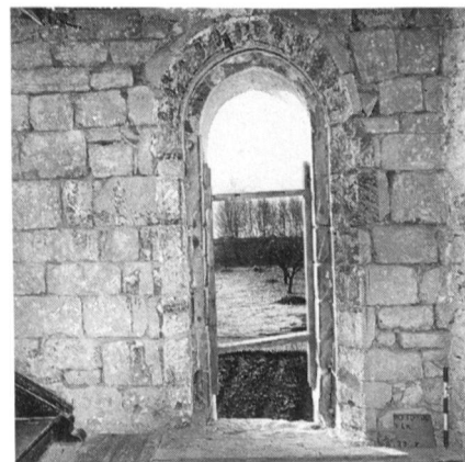
Fig. 19 Fenêtre du mur sud de la nef; les blocs de son encadrement ont été calés par les maçons à l'aide de coins de bois taillés dans des arbres abattus, d'après la dendrochronologie, en automne-hiver 1345-1346. Traces des décors peints des XIV e et XVI e siècles
