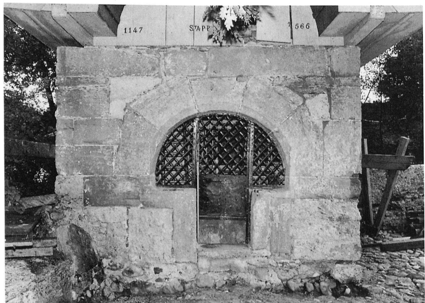
Fig. 239 Villars-sur-Glâne et Posieux / Ste-Apolline. Façade de la chapelle après enlèvement du crépi de ciment
