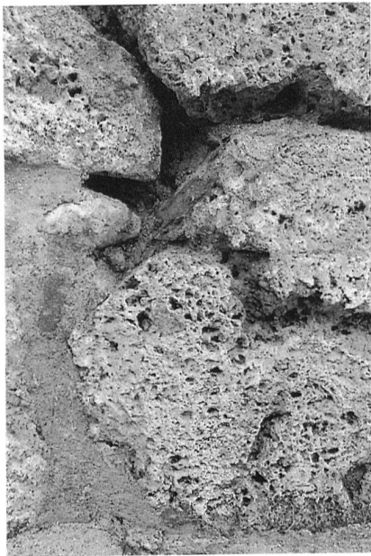
Fig. 237 Villars-sur-Glâne et Posieux / Ste-Apolline. Culée de la rive droite, côté amont, amorce d'une voûte ou appui d'un bras de force
