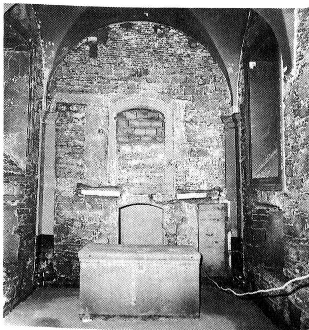
Fig. 84 Fribourg/Ancien Hôpital des Bourgeois. Le chœur après décrépiçage
