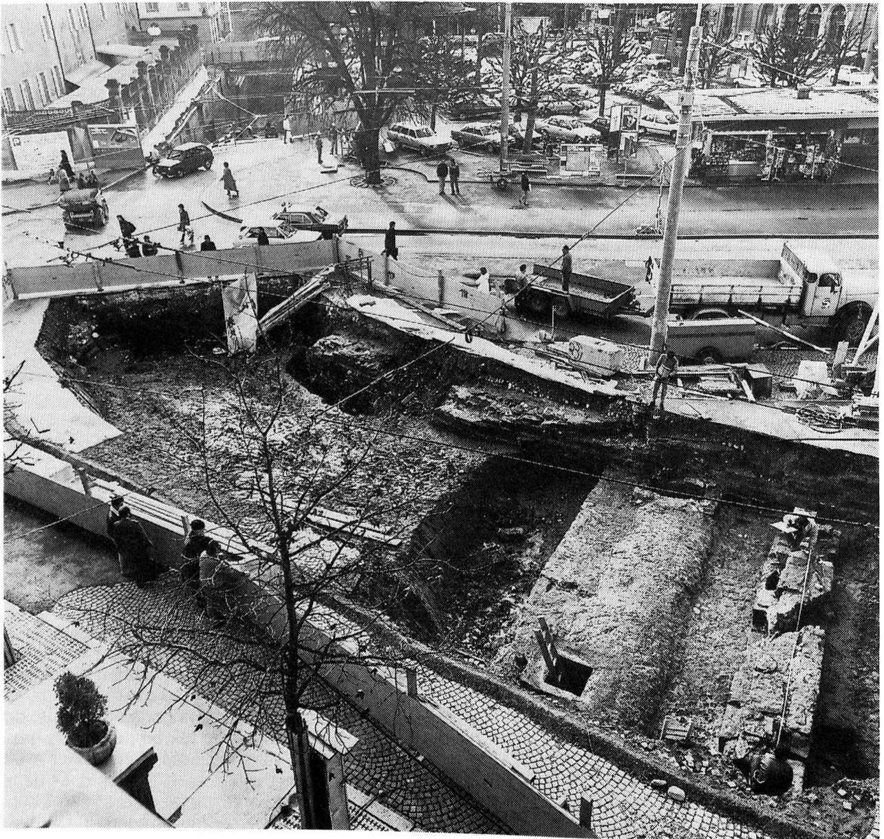
Fig. 64 Fribourg/Parking des Alpes. Vue générale des travaux du XVIII e siècle depuis l'Albertinum
