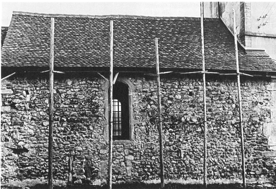
Fig. 107 Montbrelloz/Ancienne église . Mur nord de la nef gothique en cours de restauration
