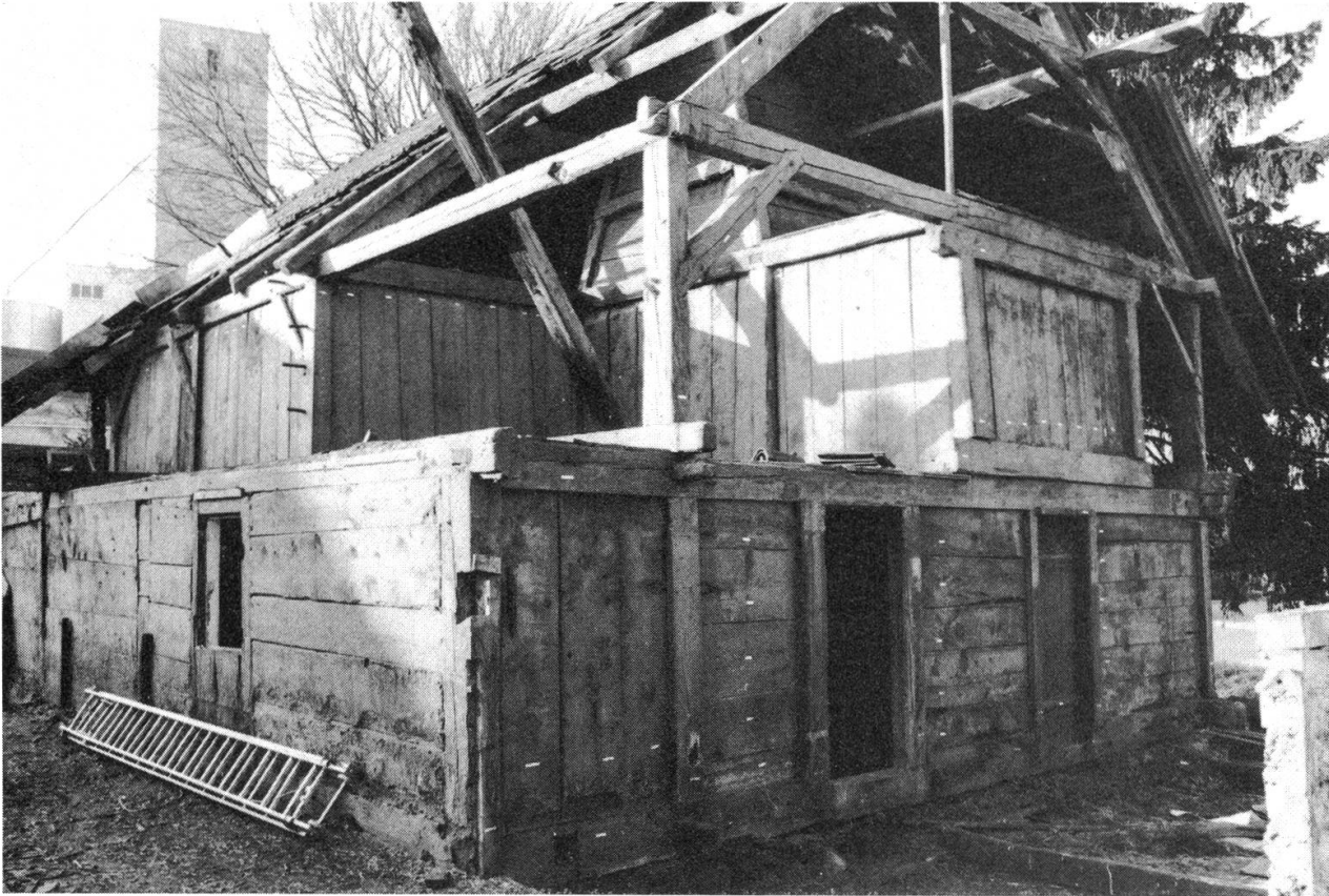
4 Die Rückseite des von den späteren Anbauten befreiten Wohnteils (2. Bauetappe) zeigt das Prinzip des Ständerbaus: In das von waagrechten Schwellen und senkrechten Ständern gebildete Rahmenskelett werden liegende oder stehende Bretter eingenutet. (Foto Bauernhausinventar, Freiburg)
