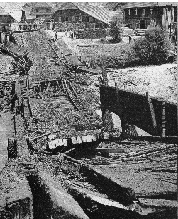
Die Zollbrücke bei Zollbrück wurde in der Nacht vom Donnerstag auf Freitag ein Raub der Flammen (Photo W. Nydegger)
