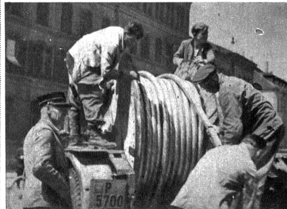
Wenn andere Leute daheim sind oder vielleicht sogar schlafen, tauchen die Heizermännchen der Stadt auf. Ihre Tätigkeit können sie meist nur bei stillgelegtem Verkehr ausüben. Es sind die Kabelleger und die Strassenarbeiter. Ihnen hat es der Städter zu verdanken, dass jeden Tag das Licht funktioniert, dass er keinen Gasunterbruch erleidet und vieles mehr. Es ist eine strenge Arbeit und erfordert den Einsatz des Mannes zu jeder Tages- und Nachtstunde
