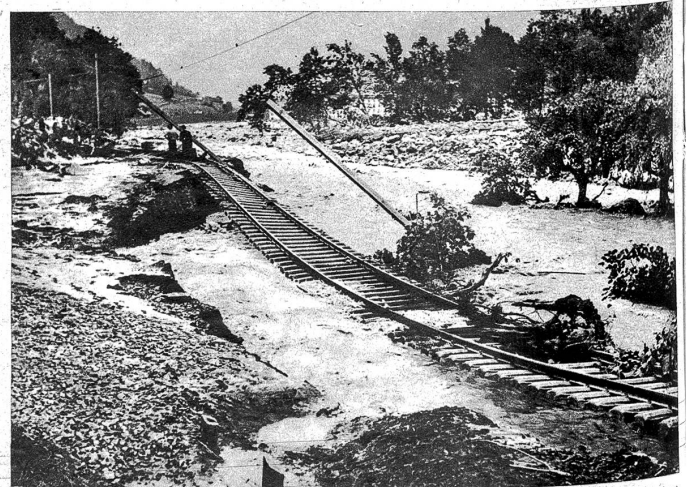
Die Verwüstungen im Glarnerland durch das Unwetter der letzten Woche. Die unterspülte Linie nach Linthal.
