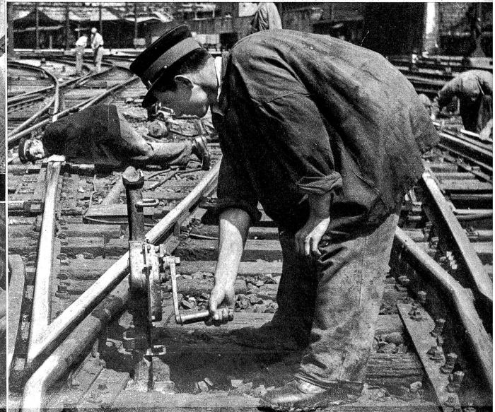
10 Tonnen Traglast überwindet die Stahlgelisewinde, die zur Nivellierung der Schienen benützt wird. Nur ausgesuchtes Material und sehr gewissenhafte Ausführung garantieren für die Leistung
