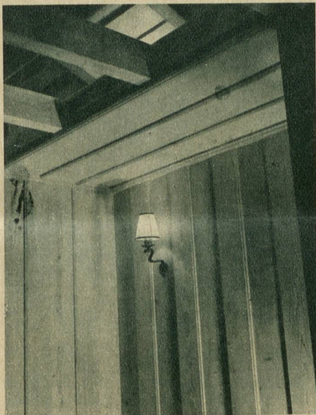
In einem andern Teil des Ausstellungsobjektes sind Täfer und Decke aus Weisstannenzholz angefertigt
