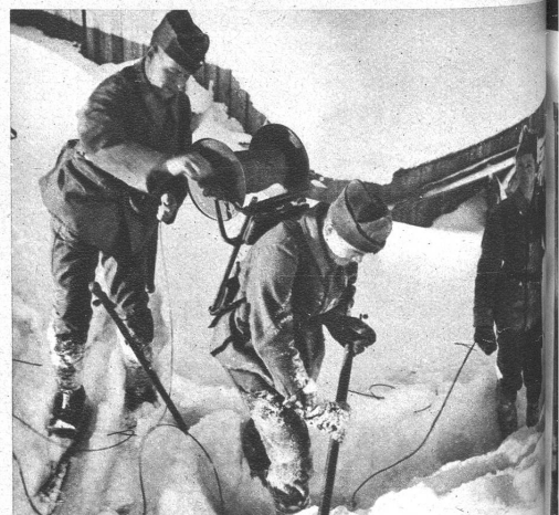
Kein Vergnügen, Leitungsbau im metertiefen Schnee! Das Bild am Rücken wiegt mit der vollen Rolle an die 30 kg
