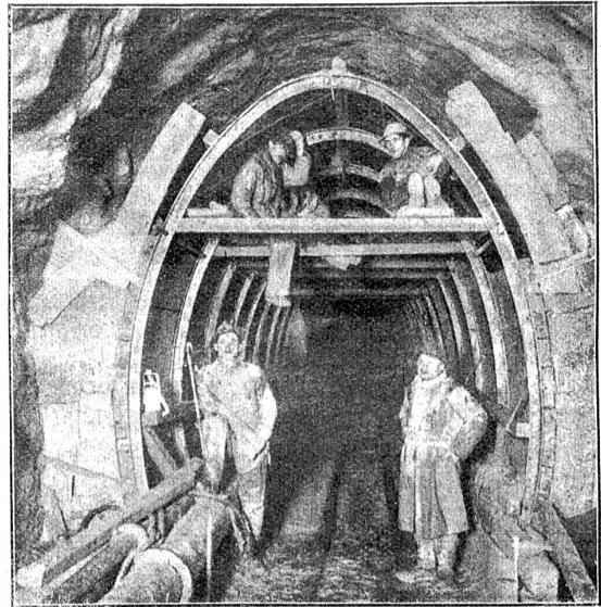
Sulgenbach-Stollen bei km 654. Eiserner Schablonen tragen die hölzerne Einfallung, hinter welcher der Beton eingebracht wird. Widerlager bereits erstellt. (6. Nov. 1922.)
