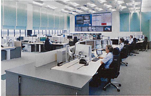
Die neue Einsatzleitzentrale befindet sich in den ehemaligen Räumlichkeiten der Flugsicherung am Flughafenkopf.
