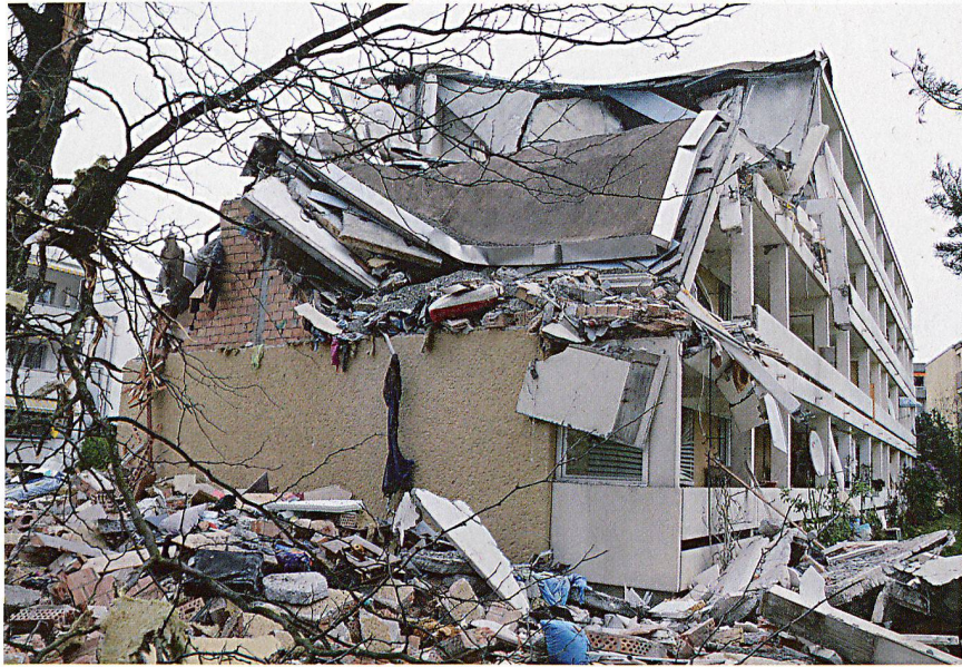
Auswirkungen der Explosion auf die Liegenschaft.
