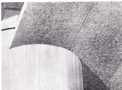
Hängendecke mit Perfecta-Akustikplatten
