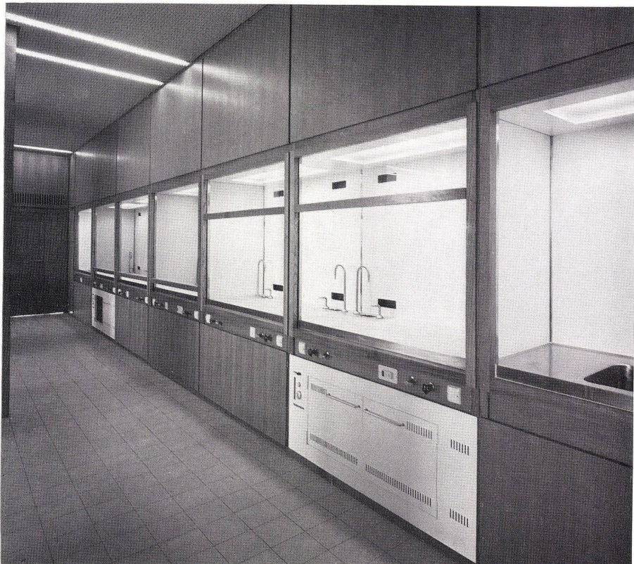
Forschungslabor im Obergeschoß. Abzugsgruppe mit eingebauten Trockenschrank. Laboratoire-type dans étage supérieur. Gaines avec placards secs intégrés. Standard lab on first floor. Exhaust ducts with built-in dry lockers.
