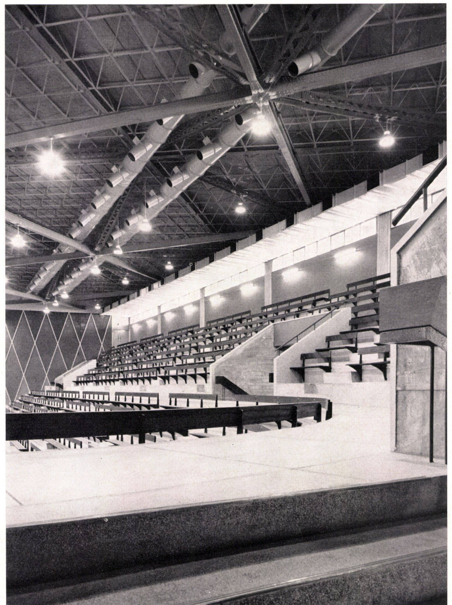
Umgang auf dem 1. Obergeschoß. Die Luft wird in zylindrischen Kanälen unter dem Trägerwerk in die Halle befördert und von dort in Rohrstützen ausgeblasen. Galerie du 1er étage. Des canaux cylindriques amènent l'air sous les sommiers en treillis et le soufflent dans la halle. Gallery on first floor. Air is introduced into the hall by cylindrical ducts under the girders and from there blown into hollow supports.
