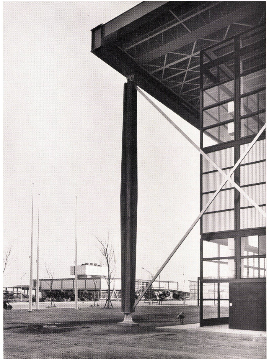
4 Vorfabrizierte Pendelsäule aus Stahlbeton der Halle 1. Im Hintergrund Halle 3. Colonne articulée préfabriquée en béton d'acier de la halle 1. Au fond halle 3. Prefabricated column with ball and socket seating of steel concrete of hall 1. In the background hall 3.
