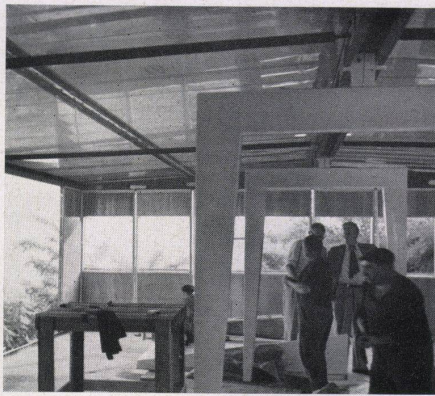
Einfamilienhaus in der Montage / Assemblage d'une maison familiale / Single-family house in erection
