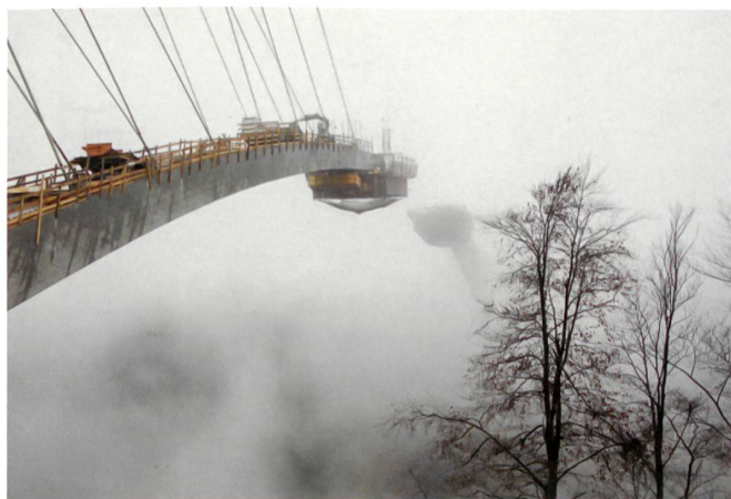
Construction en encorbellement des arcs du pont de la Tamina (photo Werner Fetzler)
