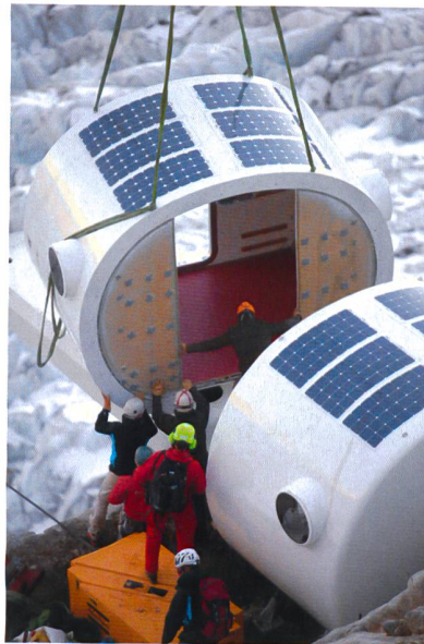
Mise en place par hélicoptère d'un module du refuge Gervasutti, au-dessus de Courmayeur (Italie) (photo Francesco Mattuzzi)
