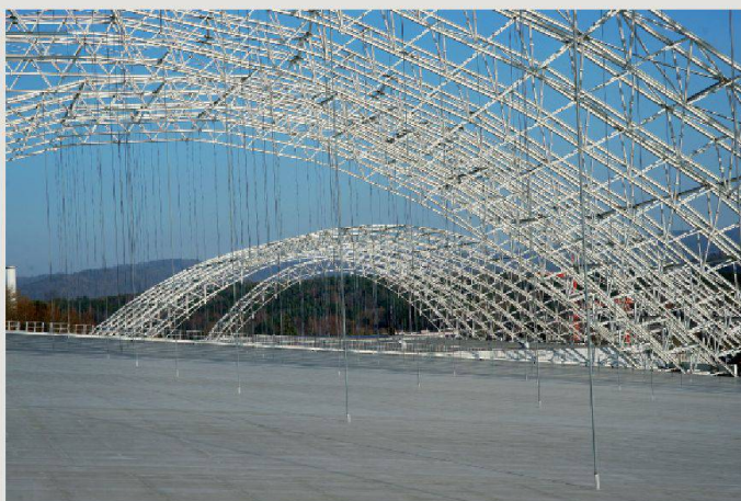
Arcs en treillis pour charpente métallique de grande portée: dépôt de déchets spéciaux SMDK, Kölliken. Entreprise totale: ARGE SMDK Infra (Mart/Züblin); conception de la construction acier: Züblin Stuttgart. (Photo SMDK Kölliken)
