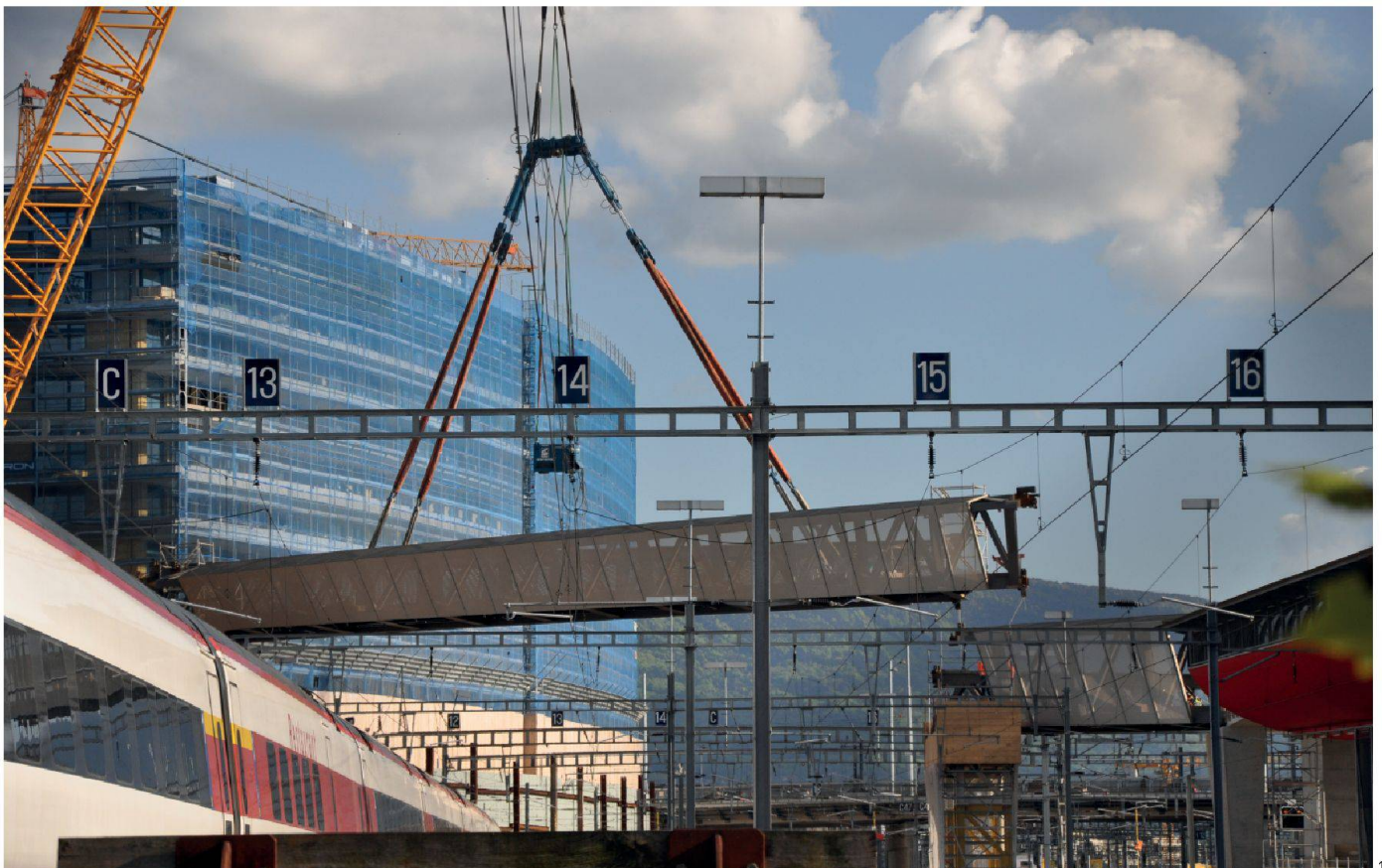
16 Pose du tronçon 6, avec le dispositif pour le réglage de la longueur des élingues (Photo ZM)
