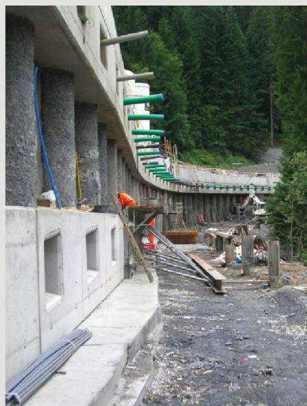
Confortement de pente à Schin: H 417a Thusis – Tiefencastel; maître de l'ouvrage: Canton des Grisons; conception: Dr. Vollenweider AG, Zurich (Photo: Roman Richner, Zurich)
