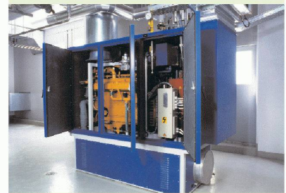
Couplage chaleur-force (CCF) équipé d'un moteur à gaz
