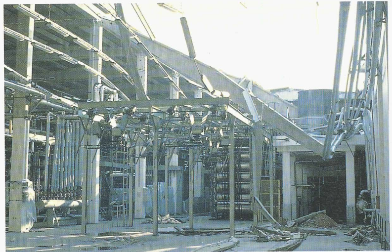
Fig. 7.- Portion effondrée du toit d'une usine, entraînant la destruction complète d'une chaîne de teinture de textile
