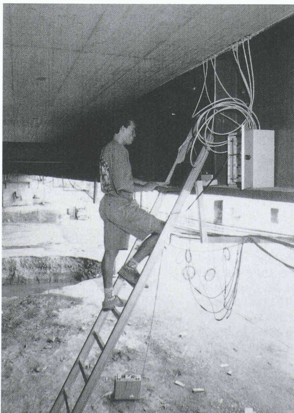
Fig. 12. - Déroulement d'une mesure de capteurs à fibres optiques auprès d'une boîte de jonction sur le pont de la Venoge (Vaud). Quatre sections ont chacune été équipées de huit fibres optiques dans la largeur de la dalle de roulement.
