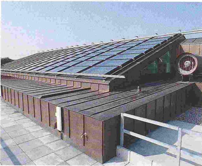
Vue extérieure du vitrage de l'atrium, avec sa double peau système tuiles.
